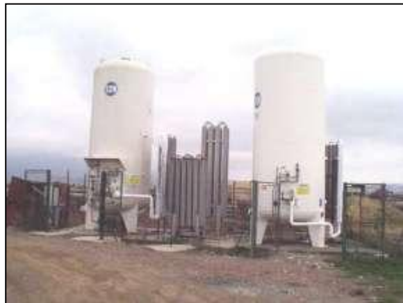
Serbatoi di ossigeno liquido
